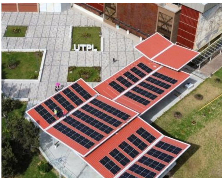
Central Solar en el campus de la UTPL
