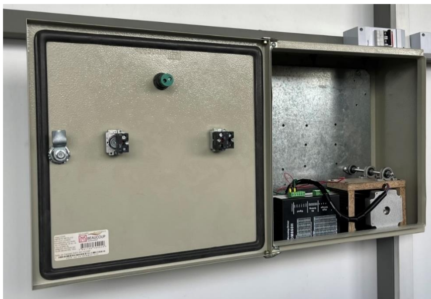
Caja metálica utilizada
